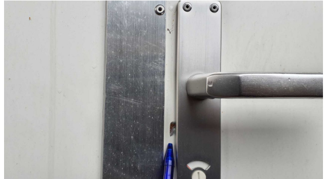
Beschädigung 2: Tür vorn links: Griff innen (+ Rostläufer, Dellen mit Lackschaden) - abweichend Auslieferungszustand -
