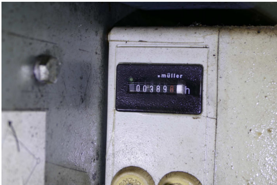
Bild 6 Betriebsstundenzählerstand zum Zeitpunkt der Besichtigung
