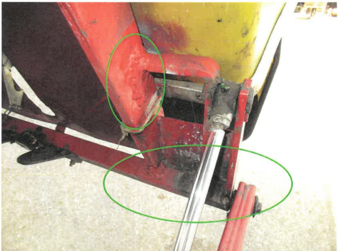
Bild 18 : Hochentleerung Rahmen mehrmals Reparaturschweißungen
