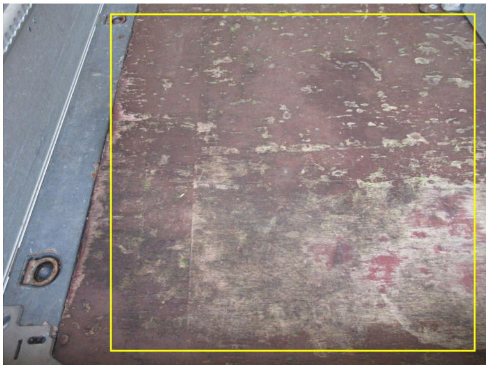
Bild 30 : Aufbau Bodenbelag verschürft
