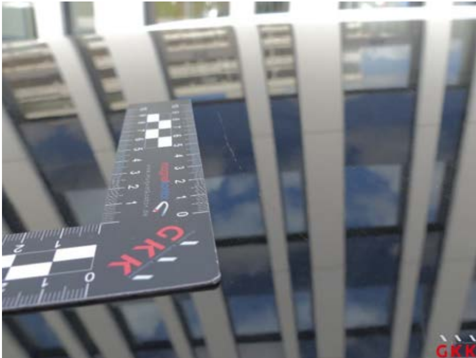
Bild 37 Dach, verkratzt, lackieren
